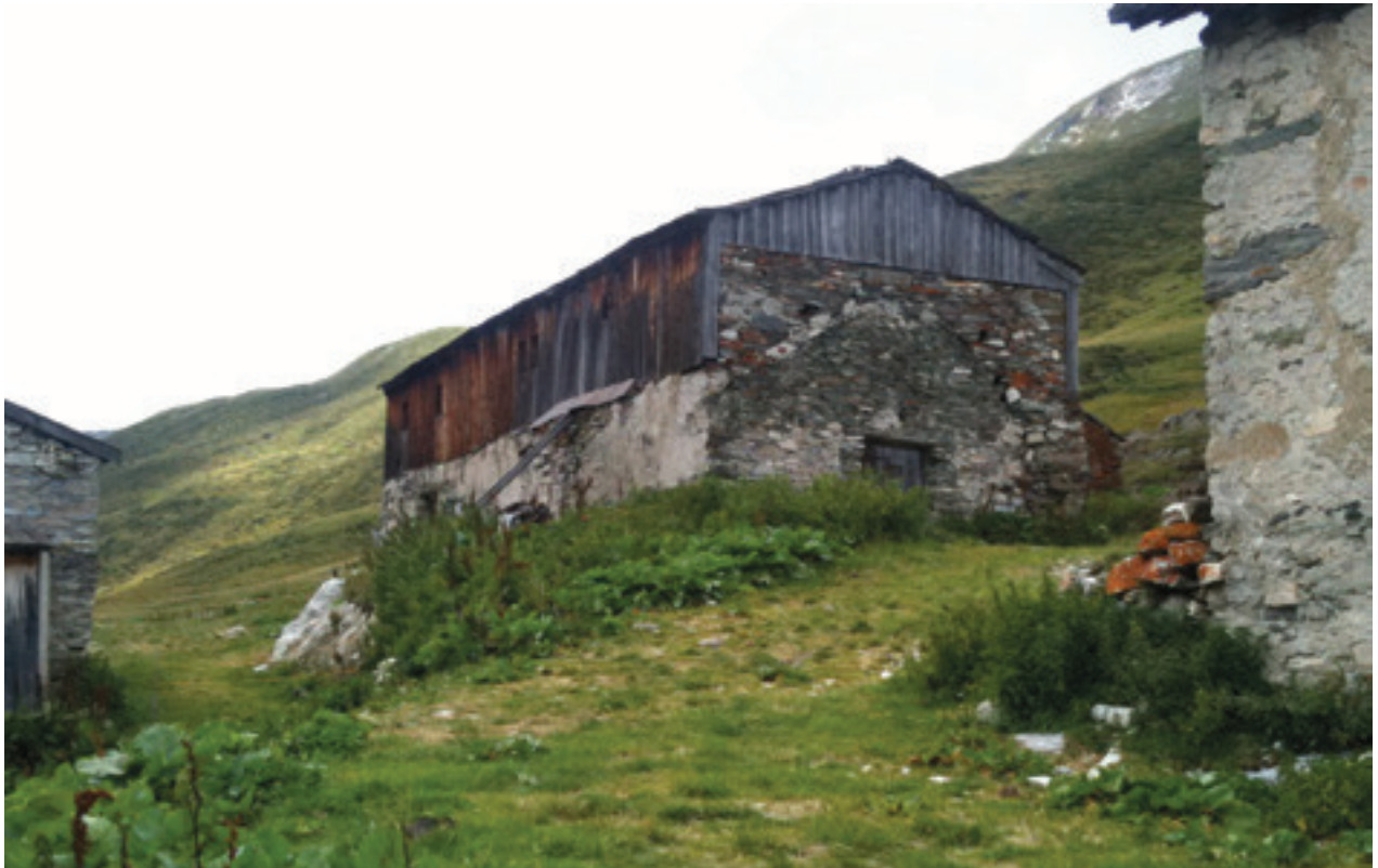
117. Defereggental, Almhütte der Jagdhausalm vor dem Austausch der Westmauer aus statischen Gründen
